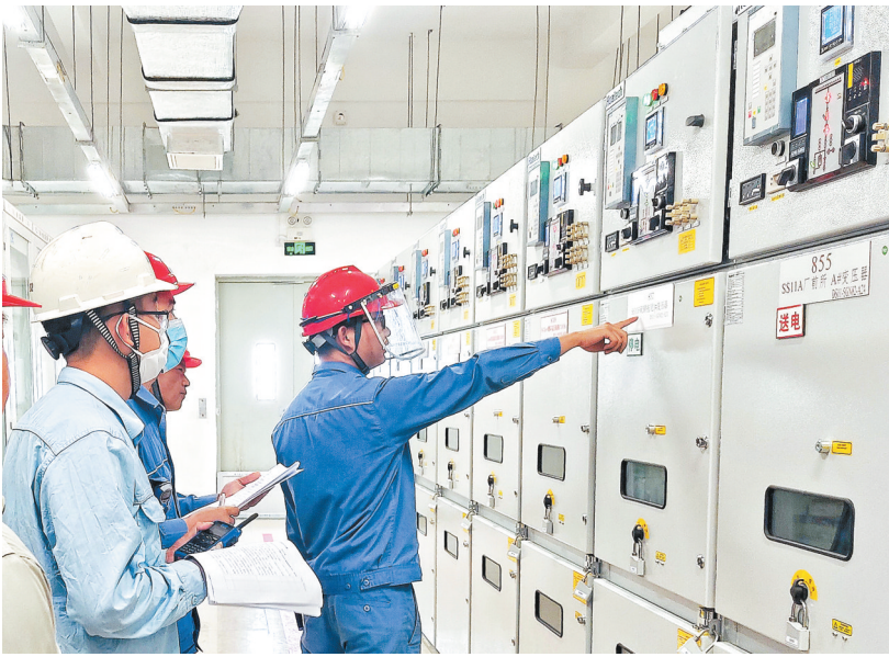
中科炼化硫磺回收装置环保设施变电所受电前,操作人员进行条件确认。
