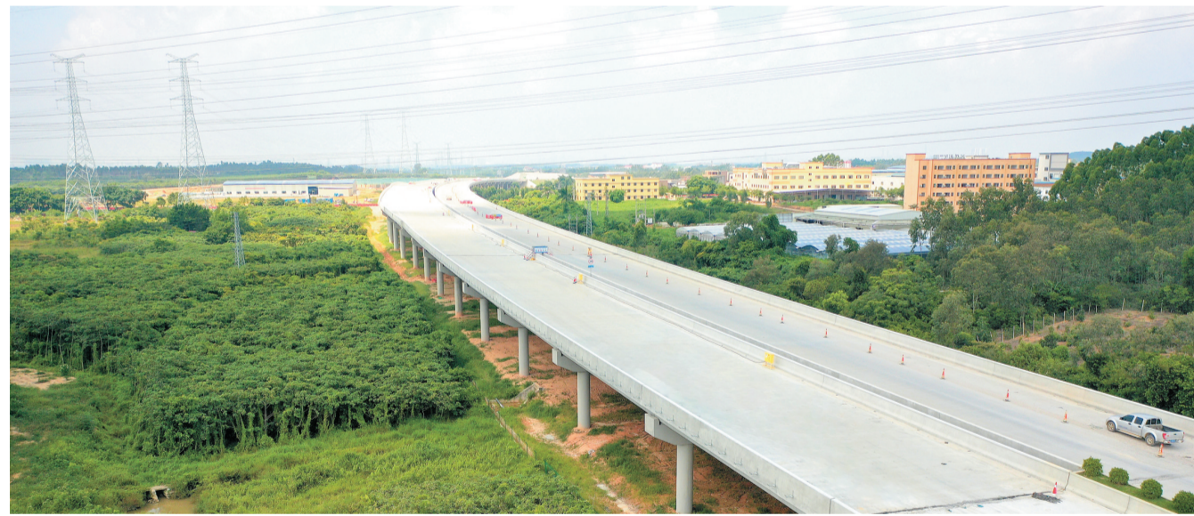
湛江机场高速一期工程计划年底建成通车。 通讯员 付森 叶玮珩 摄
