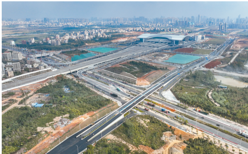
12月12日,广湛高铁湛江北站进出站通道施工已基本完工。本报记者郎树臣 摄
